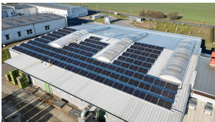
Fotovoltaická elektrárna v Luštěnicích
